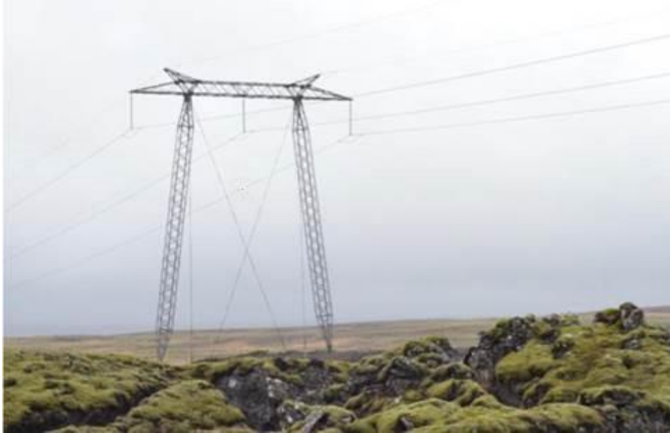
Mynd 6.1 Mastur í Búrfellslínu 3b, stagað stálgindarmastur.
